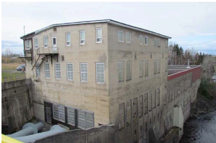
Second bâtiment du site de l'usine de pâte et papier Mohawk répertorié dans le cadre de notre inventaire. Les fenêtres du rez-de-chaussée et celles de l'étage, tout comme la structure de béton, sont d'origine. Les corps secondaires ont perdu leur toiture. IMG_4891.jpg
