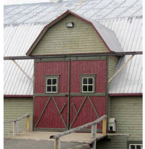
Détail du portail au toit brisé. IMG_2683.jpg
